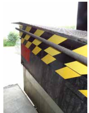
▲ Flexi Armour Dock op een dock leveler
